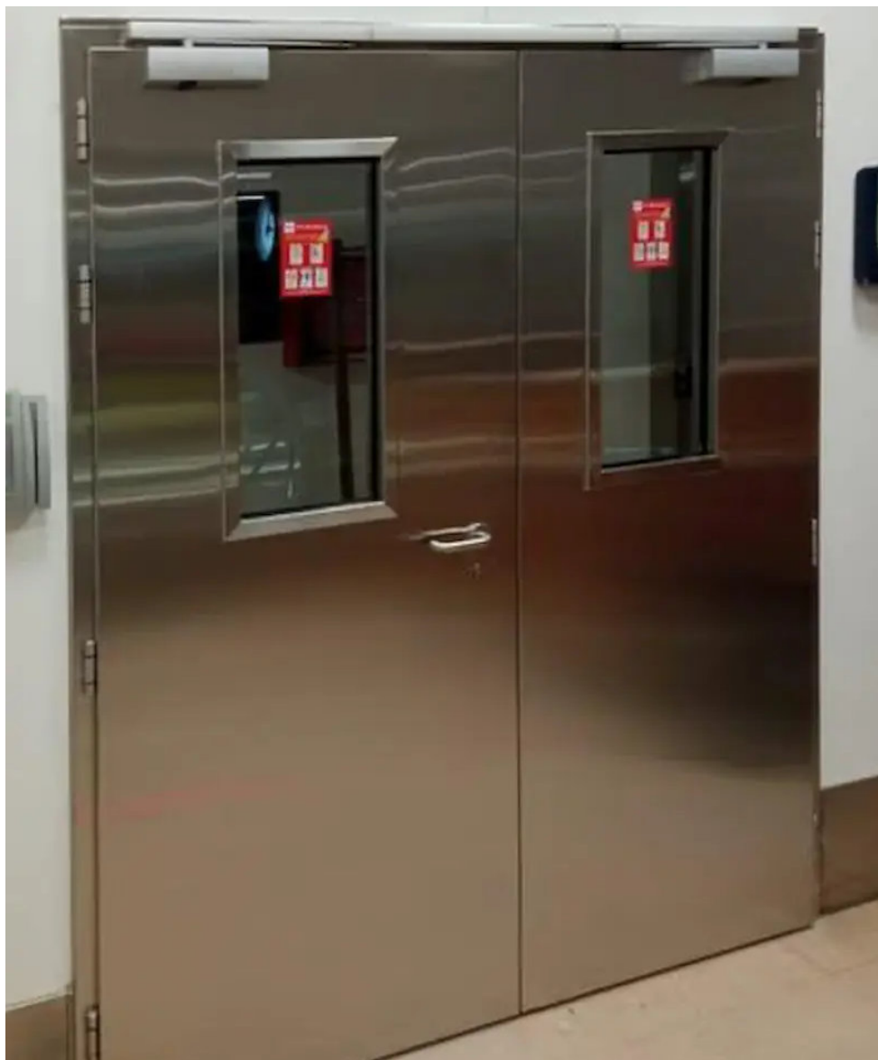
Fig.4-Puerta cortafuegos instalada en en la terminal 2 Aeropuerto Barajas Adolfo Suárez
